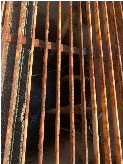
Figura 116 – Poço de Sucção da EEE Sete de Setembro.
