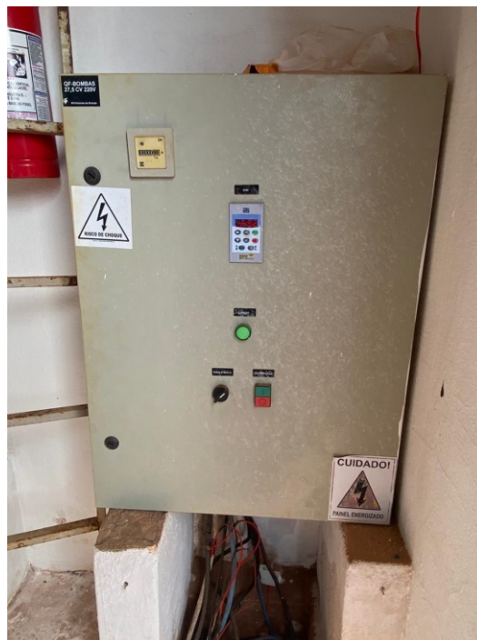
Figura 54 – Painel de comando.
