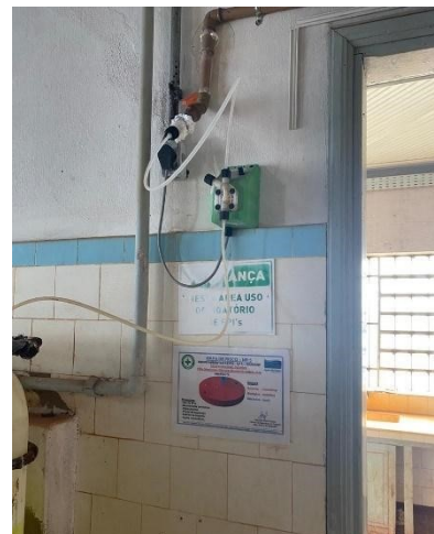
Figura 31 – Bomba dosadora de Cloro.
