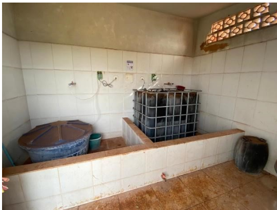
Figura 68 – Dosagem de cloro e flúor.
