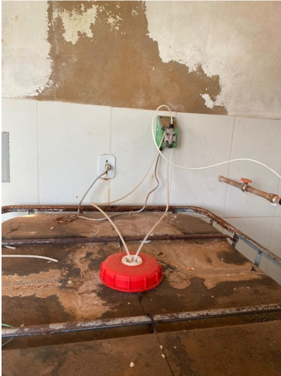
Figura 76 – Bomba dosadora de cloro.
