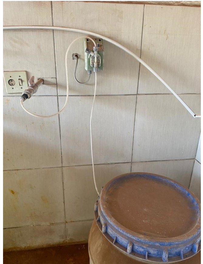
Figura 47 – Bomba dosadora de flúor.
