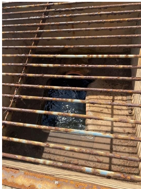
Figura 124 – Chegada do Efluente na ETE Guará.
