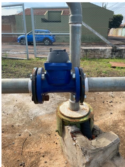
Figura 50 – Macromedidor poço UP 09.
