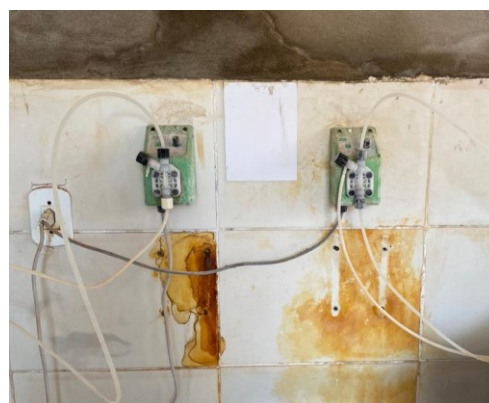
Figura 39 – Bombas dosadoras de cloro e flúor.
