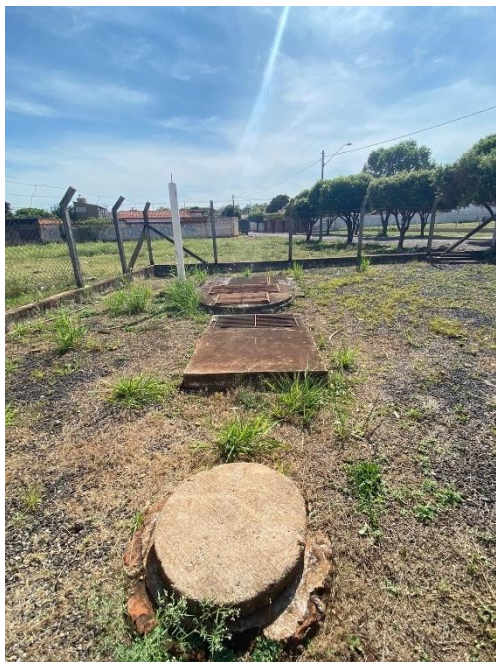
Figura 115 – Estação Elevatória de Esgoto Sete de Setembro.
