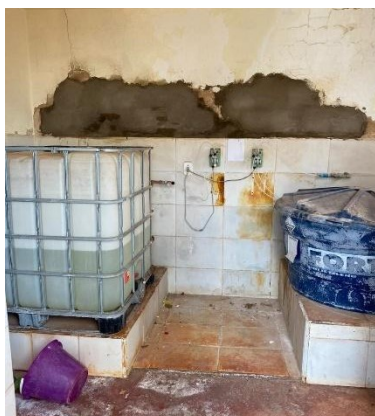
Figura 38 – Dosagem de cloro e flúor.
