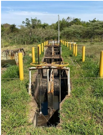
Figura 120 – Estação Elevatória de Esgoto da ETE Guará.
