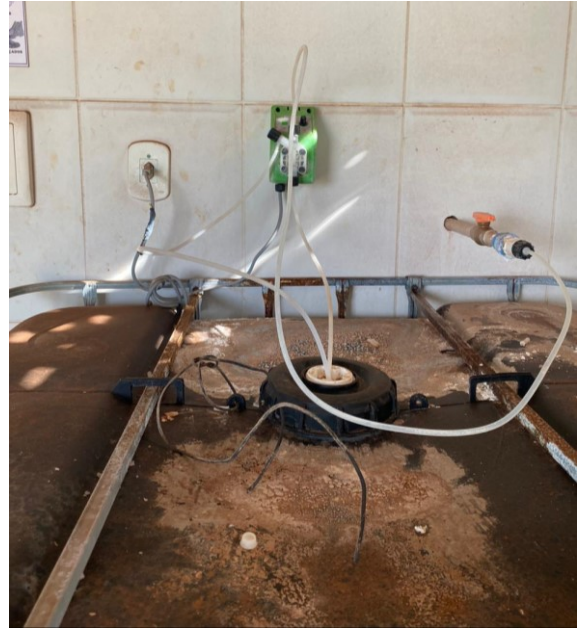
Figura 69 – Bomba dosadora de cloro.
