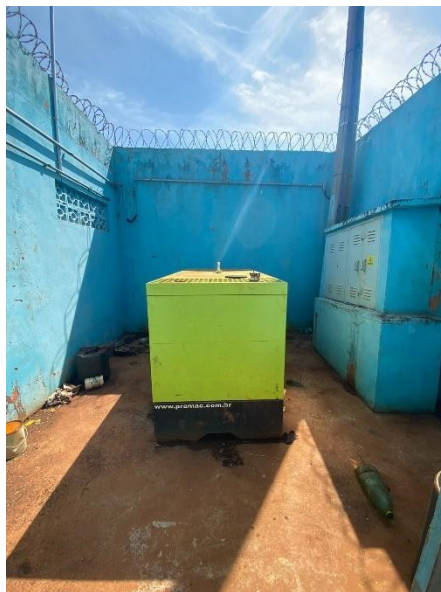
Figura 133 – Gerador de Energia.
