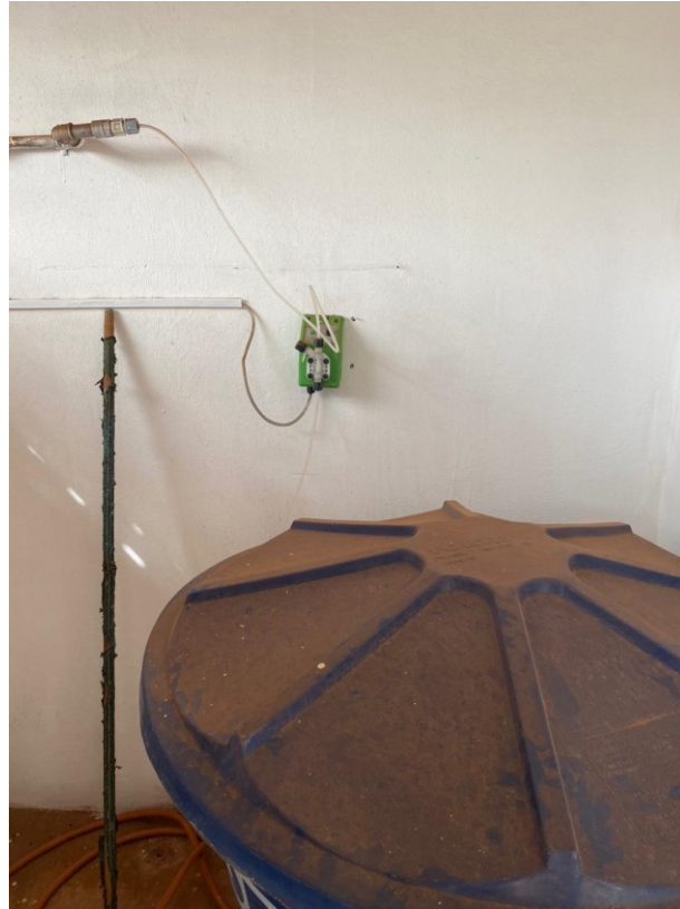
Figura 53 – Bomba dosadora de flúor.
