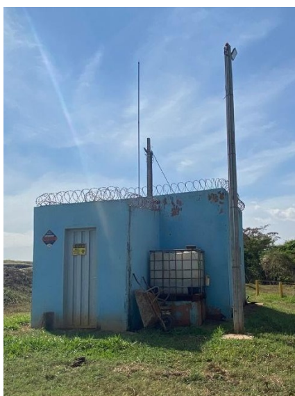
Figura 132 – Casa do Gerador.
