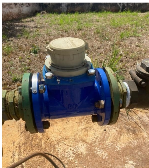
Figura 80 – Macromedidor UP Pioneiros.
