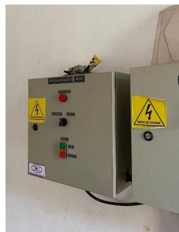
Figura 92 – Painel de comando.
