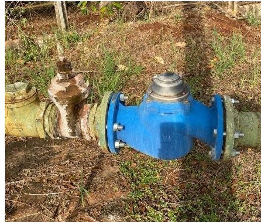
Figura 29 – Macromedidor Poço UP03.
