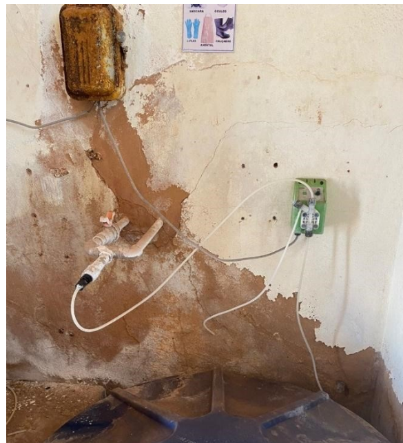
Figura 86 – Bomba dosadora de flúor.
