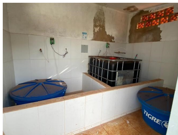
Figura 75 – Dosagem de cloro e flúor.
