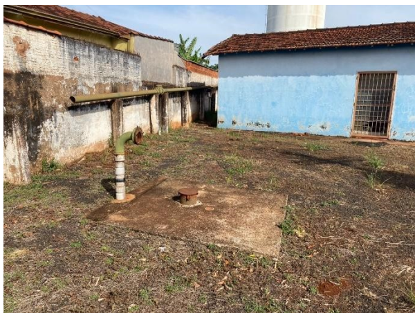
Figura 97 – Poço UP 02 desativado.
