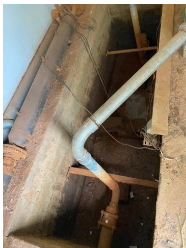
Figura 90 – Tubulação Booster Itapema.
