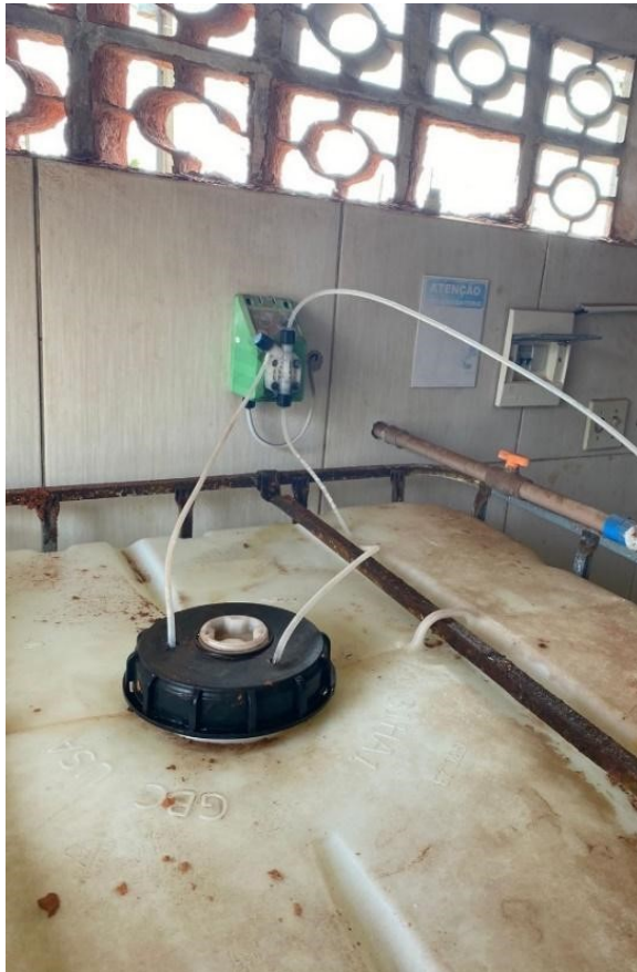
Figura 46 – Bomba dosadora de cloro.
