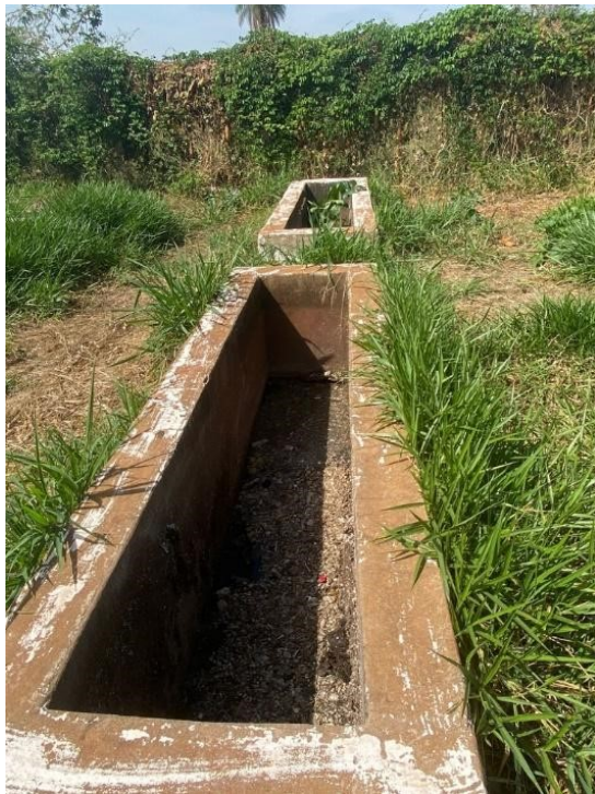
Figura 135 – Chegada do efluente na ETE Pioneiros.
