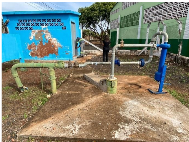
Figura 49 – Poço UP 09 com sistema de filtragem.
