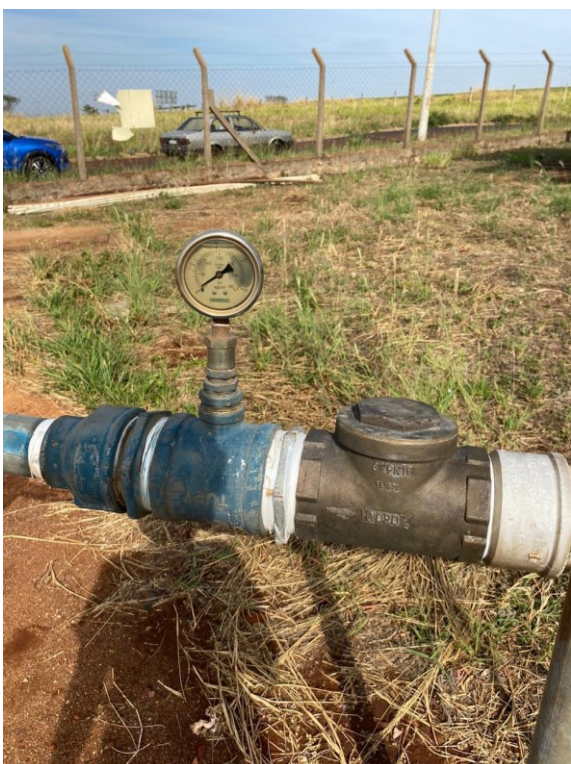
Figura 64 – Medidor de pressão – Poço UP 11.
