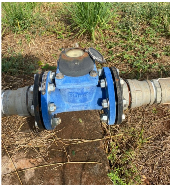
Figura 73 – Macromedidor poço UP 12.
