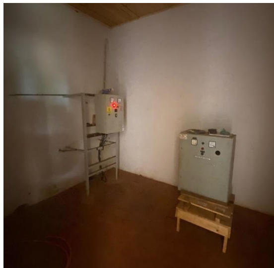
Figura 81 – Casa de máquinas.
