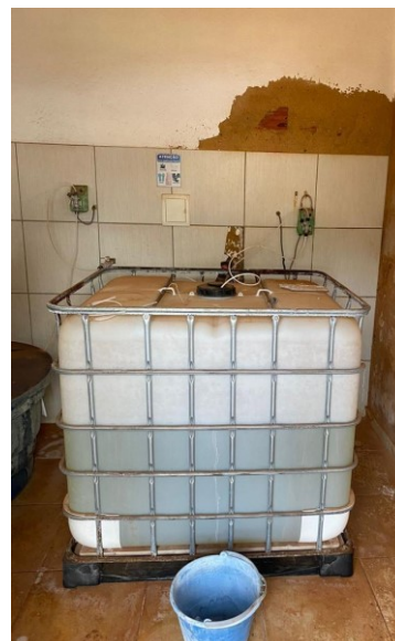
Figura 59 – Dosagem de cloro e flúor.
