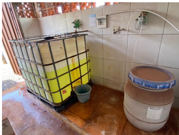
Figura 45 – Dosagem de cloro e flúor.
