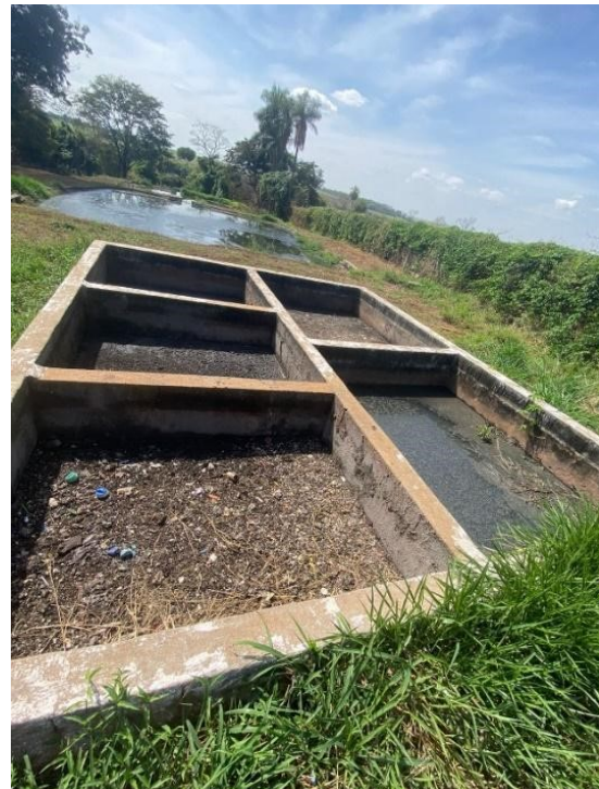
Figura 136 – Caixa de Recebimento de efluentes.
