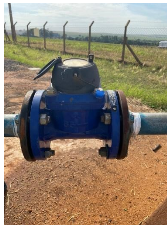
Figura 65 – Macromedidor poço UP 11.
