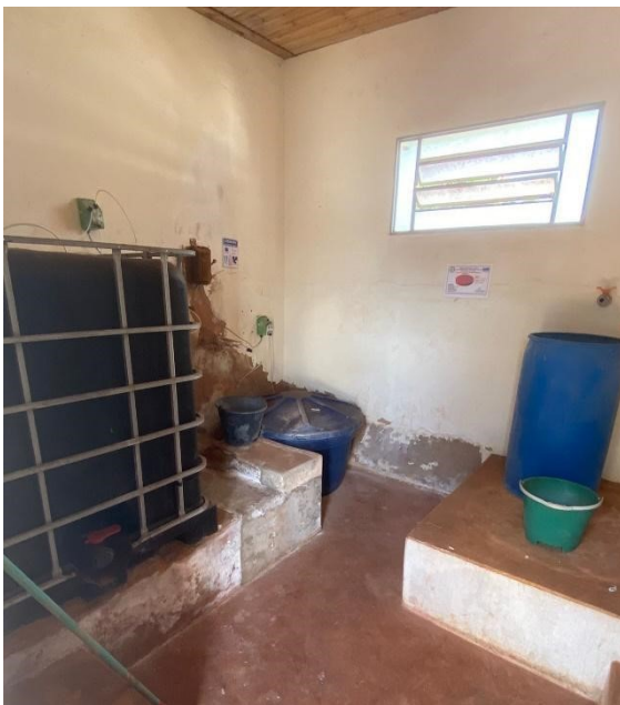
Figura 84 – Dosagem de cloro e flúor.
