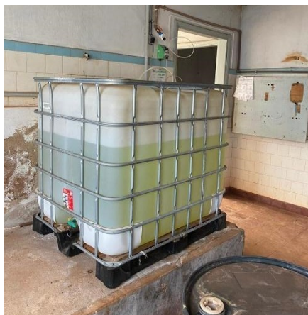
Figura 30 – Caixa de armazenamento de cloro.
