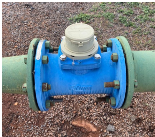
Figura 37 – Macromedidor Poço UP06.
