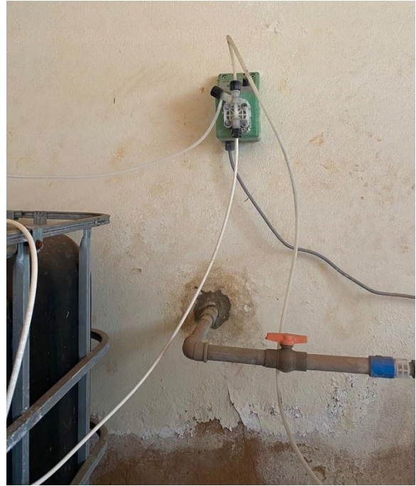
Figura 85 – Bomba dosadora de cloro.
