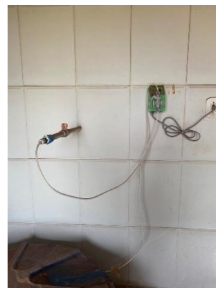
Figura 70 – Bomba dosadora de flúor.
