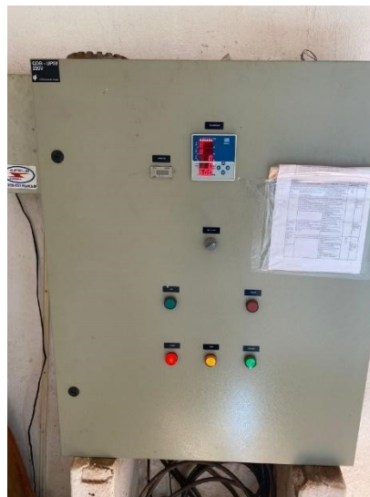
Figura 44 – Painel de Comando.
