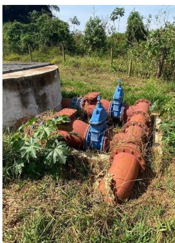
Figura 121 – Bombeamento da EEE da ETE Guará.
