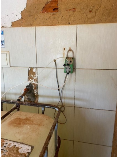
Figura 60 – Bomba dosadora de cloro.
