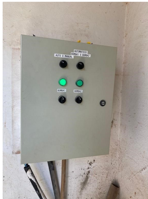
Figura 117 – Painel Elétrico da EEE Sete de Setembro.
