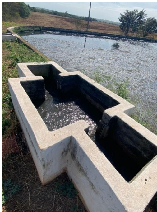
Figura 125 – Chegada do Efluente na Lagoa Anaeróbia.
