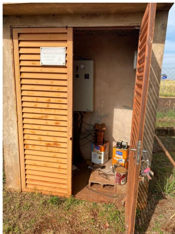
Figura 66 – Casa de máquinas.
