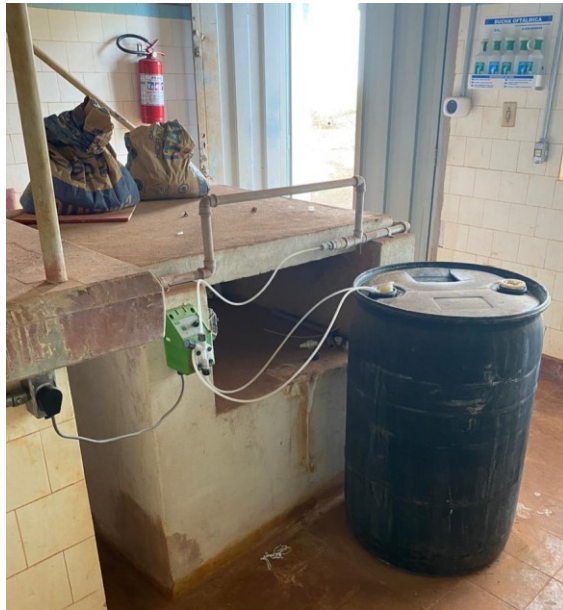
Figura 32 – Bomba dosadora de Flúor.
