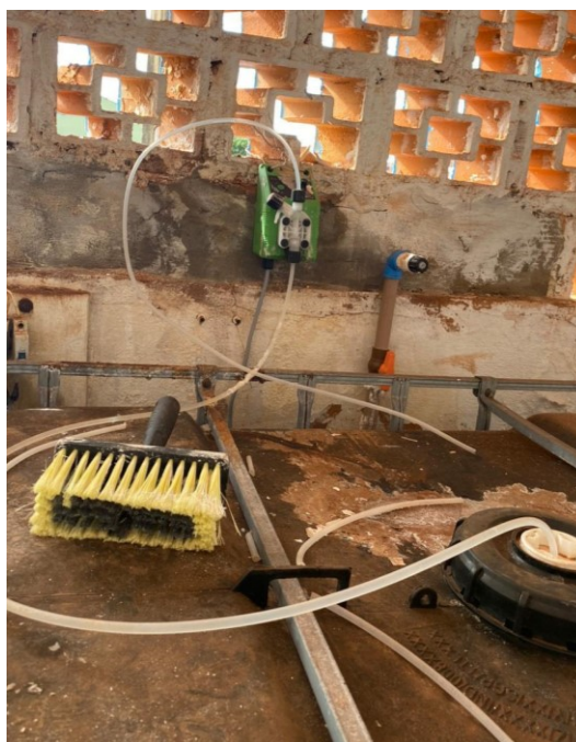
Figura 52 – Bomba dosadora de cloro.
