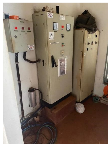
Figura 40 – Painéis de comando.
