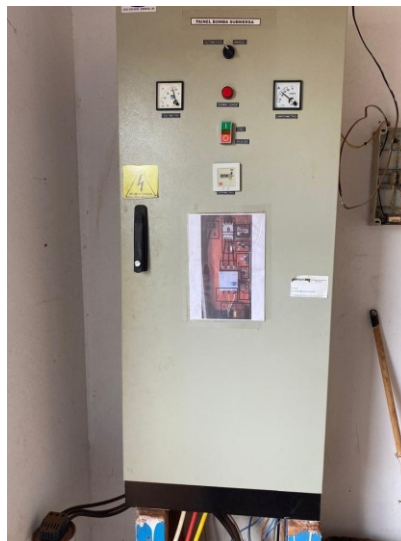
Figura 58 – Painel de comando.
