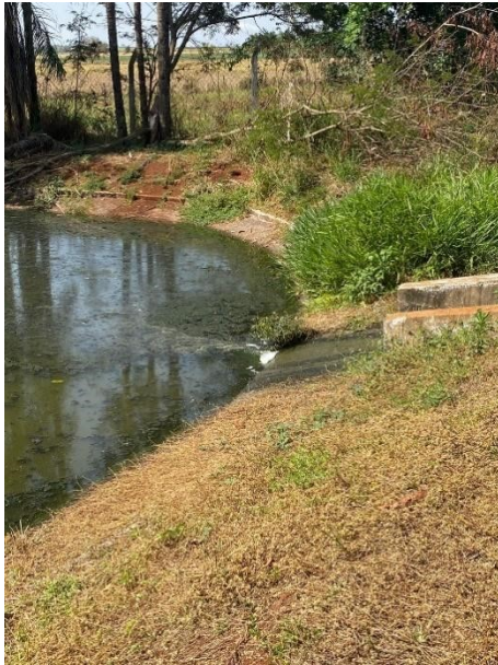
Figura 140 – Entrada do efluente na 2ª Lagoa Facultativa.
