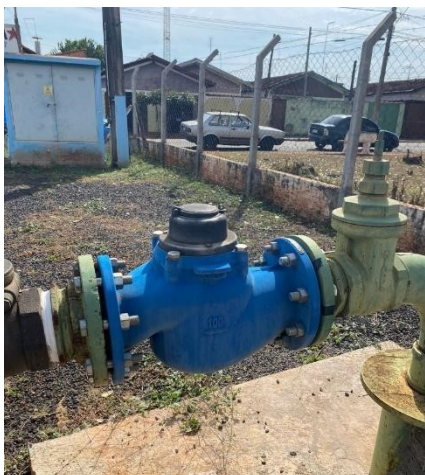
Figura 43 – Macromedidor Poço UP 08.
