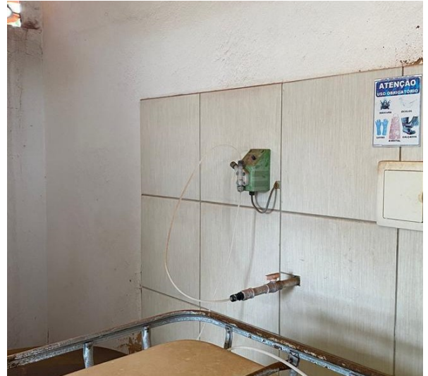
Figura 61 – Bomba dosadora de flúor.
