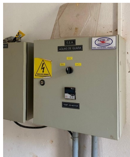
Figura 93 – Painel de comando.
