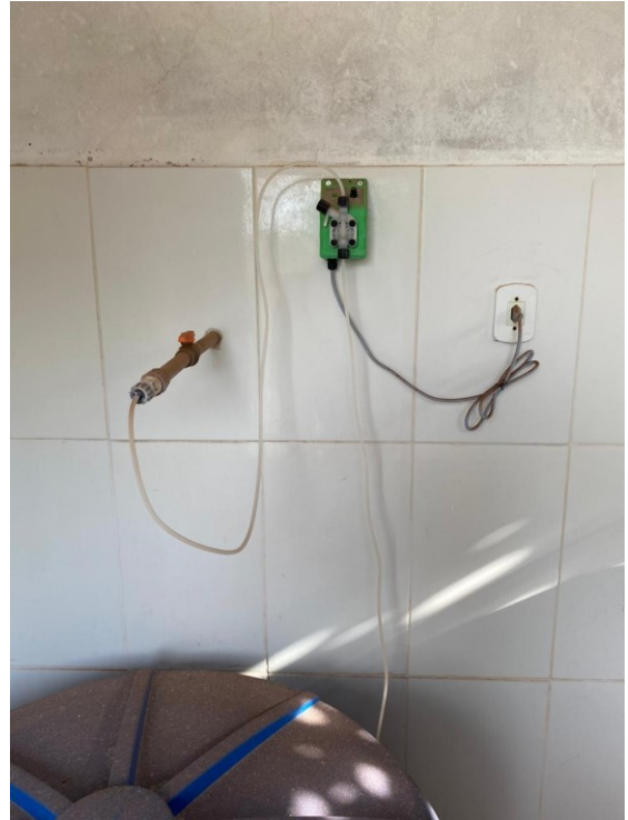
Figura 77 – Bomba dosadora de flúor.
